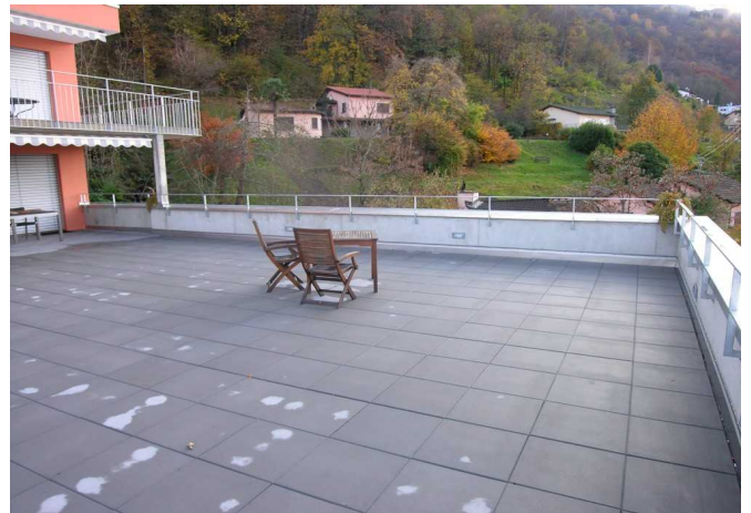
Brüstungsgeländer aus 2 horizontalen Rechteckrohren. Pfosten abgekröpft und seitlich an die Brüstung gedübelt. Feuerverzinkt.
